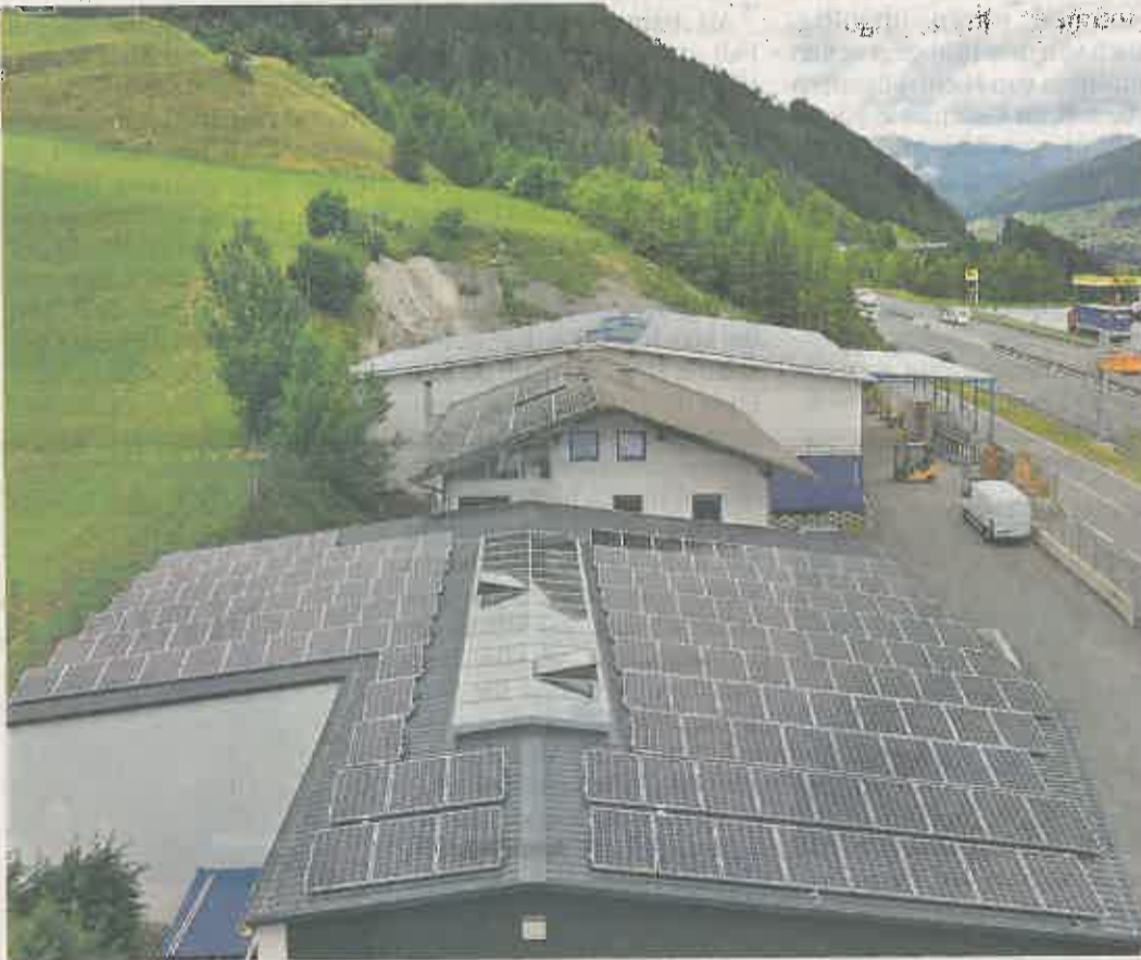
Beinahe die gesamte Dachfläche des Betriebes – zwei Werkshallen (vorne und hinten) sowie das Bürogebäude (Mitte) hat die Firma Muigg mit Photovoltaikmodulen zur Stromerzeugung ausgestattet. Foto: Muigg
